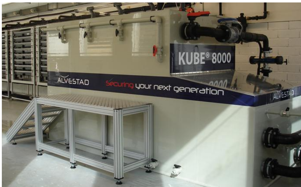
Bilde: Resirkuleringsanlegget KUBE i drift i Steinsvik
